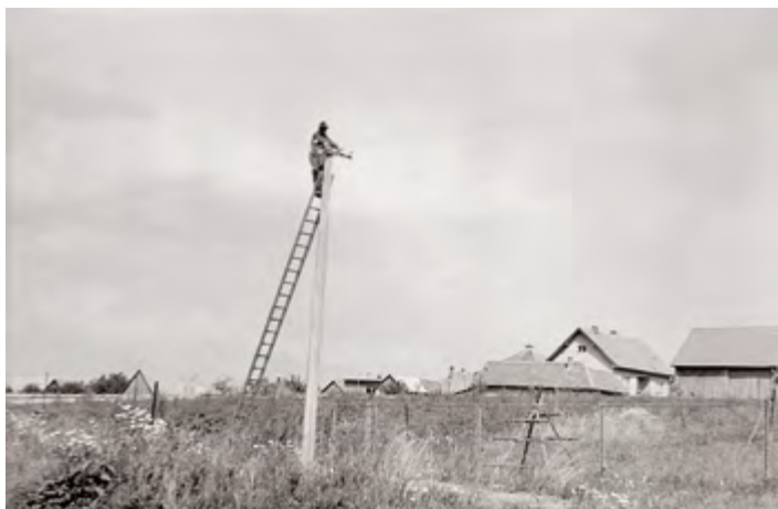
Rozšírenie elektrických sietí
